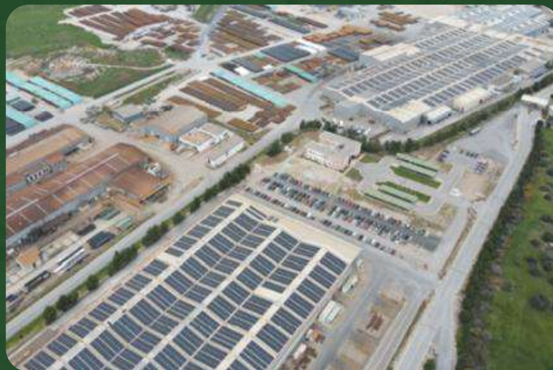
Σωληνουργεία Κορίνθου (Όμιλος ΒΙΟΧΑΛΚΟ) 7.100KWp Το μεγαλύτερο σε βιομηχανική στέγη στην Ελλάδα
