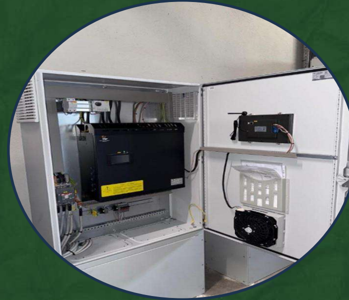
Power Quality as a Service Βελτίωση Ποιότητας Ρεύματος με σταθεροποίηση τάσης & φίλτρα αρμονικών
