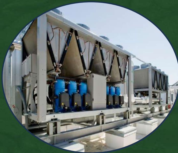
HVAC-R as a Service Αναβάθμιση Συστημάτων Θέρμανσης, Κλιματισμού, Αερισμού, Επαγγελματικής/Βιομηχανικής Ψύξης
